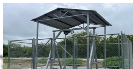
ESTACIÓN DE BOMBEO
