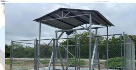
ESTACIÓN DE BOMBEO
